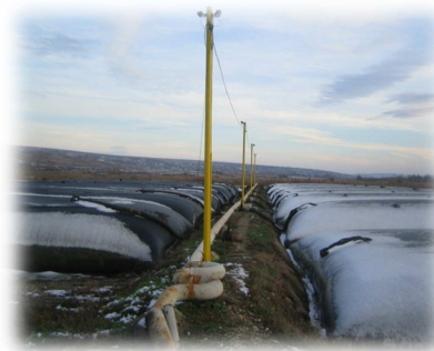
Figura 12: Geotuburile de la SEAU
