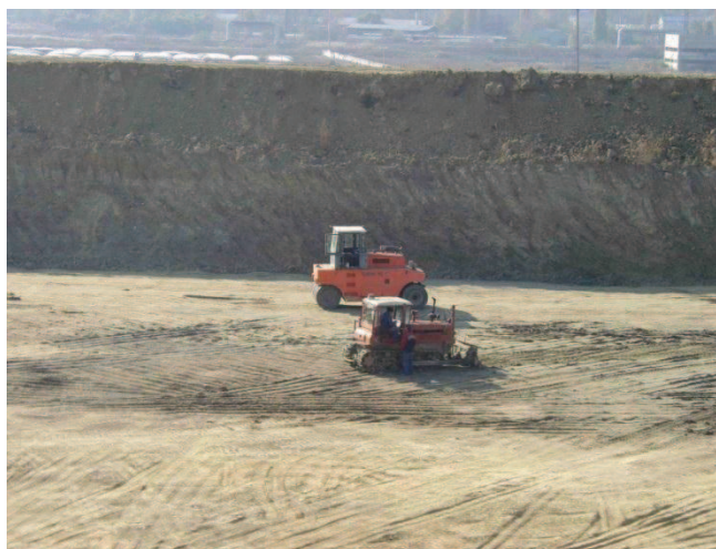
Figura 12 Construirea unui puț de nămol (noiembrie 2011) la SEAU Chișinău. În fundal pot fi observate geotuburile.
