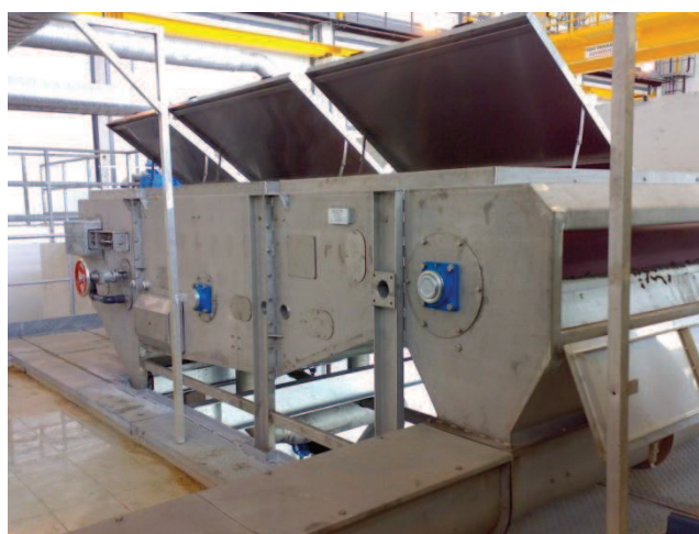
Figura 16 Îngroșător cu curea gravitațională Flavy, instalat la stațiile de tratare Pest-South și Pest-North.
