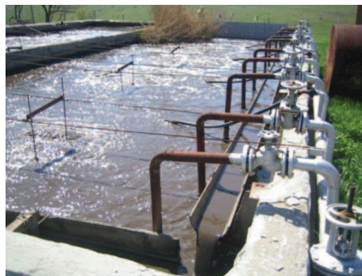
Bazin biologic cu amestec lichid recirculat
