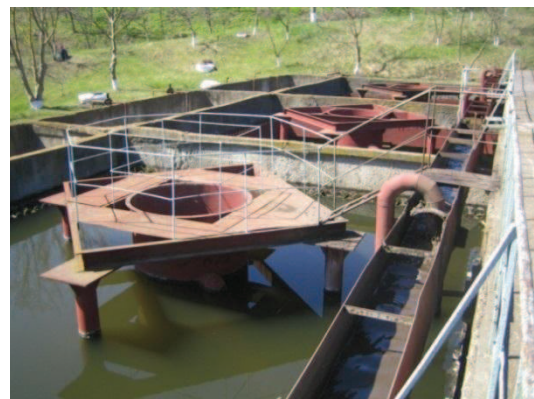
Limpezitor secundar și canal deschis pentru nămolul recirculat
